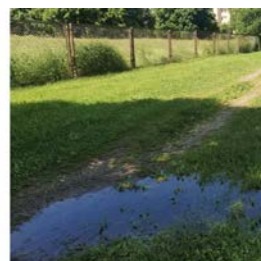
Drenavimo ir lietaus vandens sistemų trūkumas
